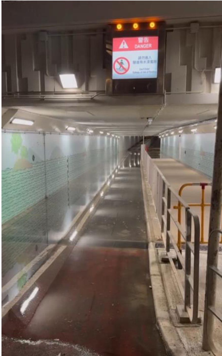
圖 2.2.5 二零二五年十月二十一日晚上沙田城門河旁的隧道出現輕微水浸。(鳴謝：Eric Cheng)
