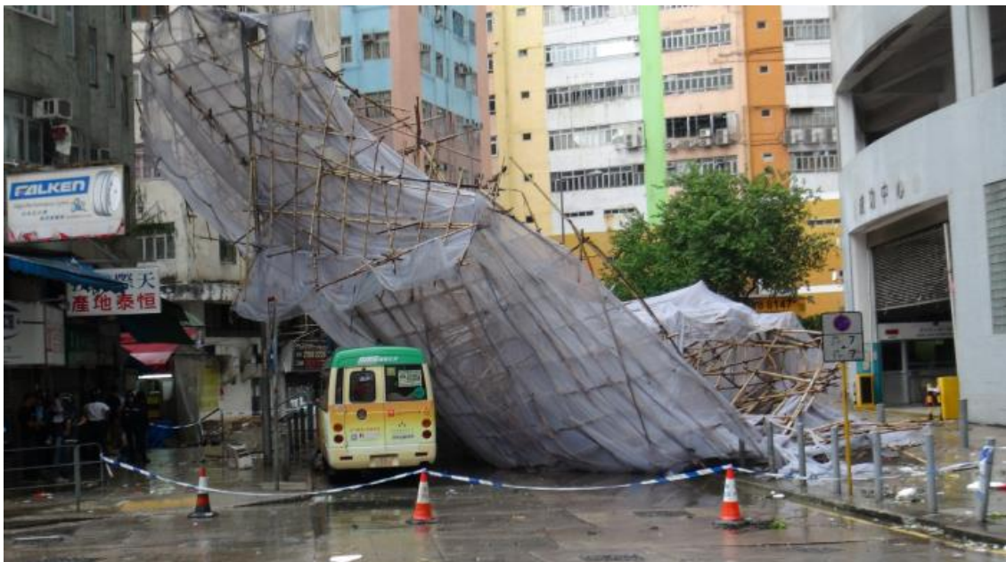
圖 3.4.9 颶風海鷗吹襲期間，葵涌打磚坪街有一幅棚架倒塌，導致一輛貨車及一輛小巴損毀(相片由星島日報提供)。
