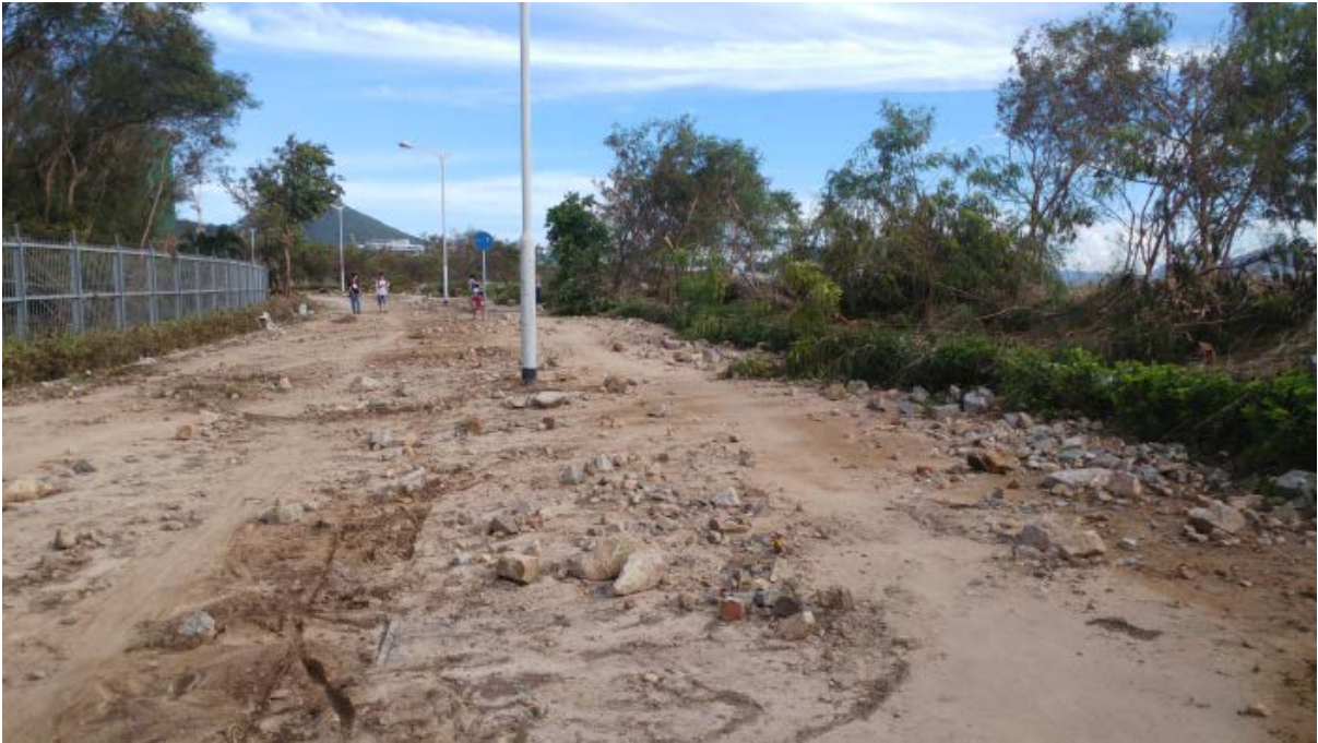
圖 3.3.19a 將軍澳海濱長廊行人路被海浪破壞。(圖片鳴謝: Bowie Wong (社區天氣觀測計劃))
