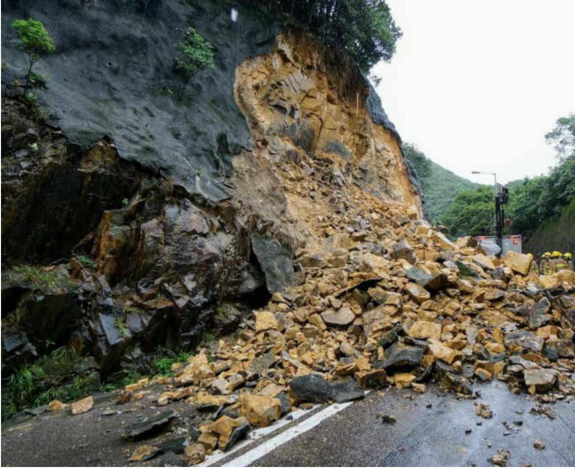
圖 3.1.7 赤柱大潭道一幅護土牆在暴雨下倒塌。(照片由土力工程處及土木工程拓展署提供)
