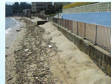
2008年，颱風黑格比引致的風暴潮侵蝕長洲海灘
