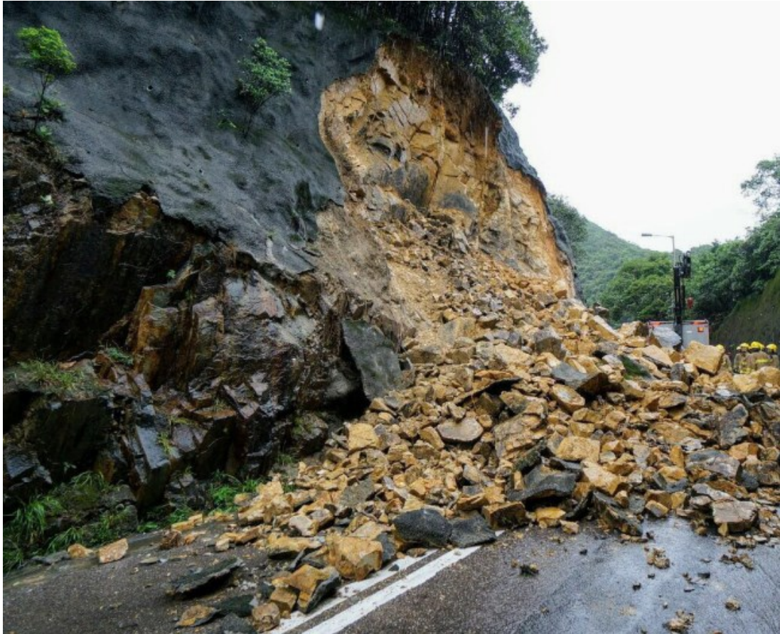
圖 2.2.7 柱大潭道一幅護土牆在暴雨下倒塌(照片由土力工程處及土木工程拓展署提供)。
