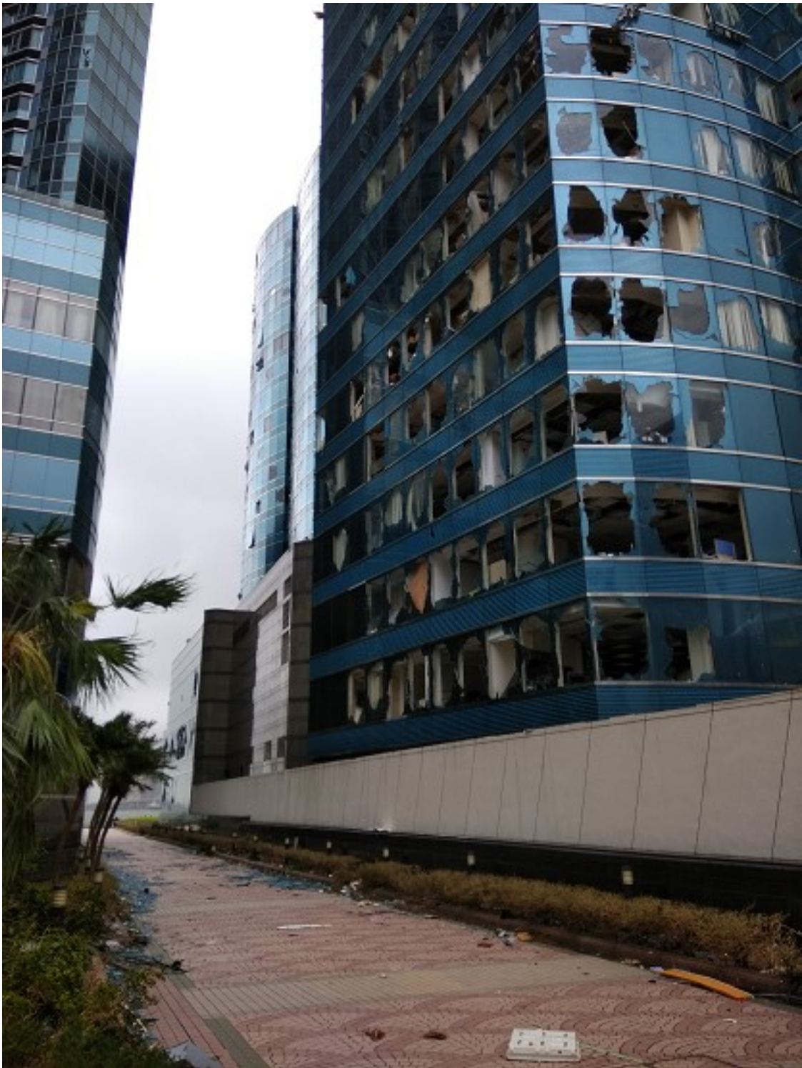
圖 1.5 山竹襲港期間紅磡有大廈玻璃幕牆嚴重破損
